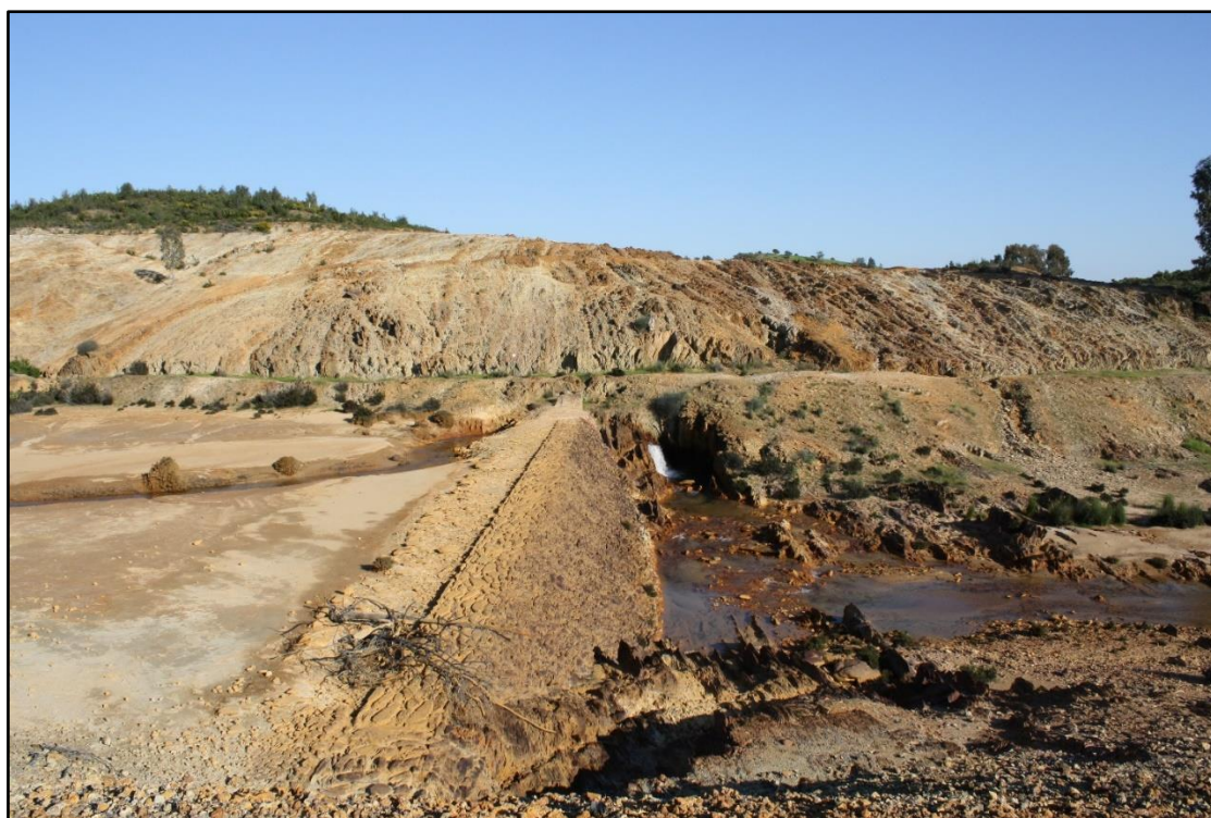
Barragem do Telheiro(açoreamento)
